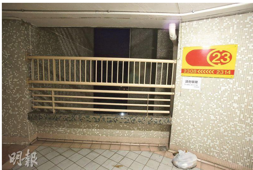
圖 1 之 1 - 男童墮樓斃命的亨業樓 23 樓走廊，鐵欄早前已加高至約 1.7 米， . . . . . (伍浦鋒攝)
